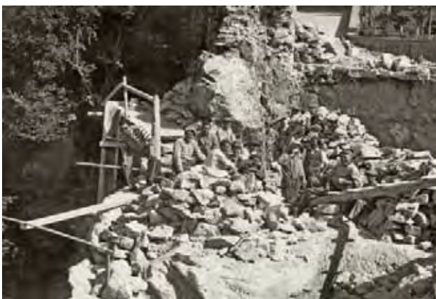
Fine anni '50: lavori di sbancamento dei picconisti dello Stato per la costruzione del lato monte della funivia.
